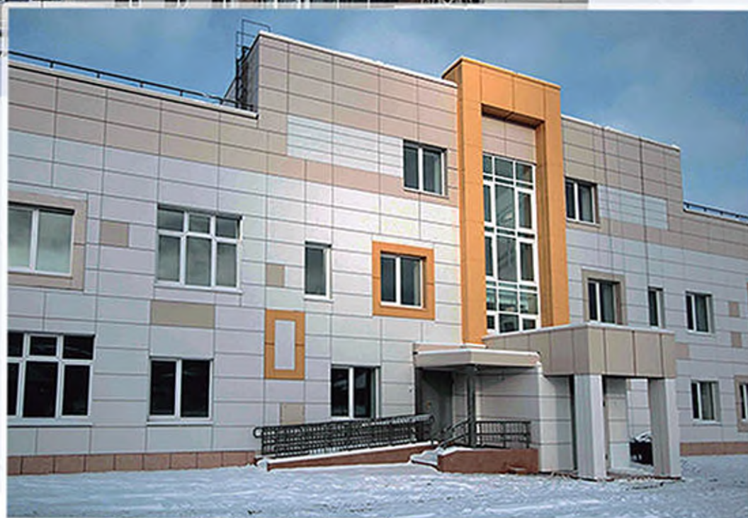
Детский сад г. Екатеринбург (2007 г) - вентфасад - оцинкованная сталь 1,2 мм с покрытием PE
